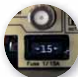
Fusibles de ré-injection de la télé-alimentation
